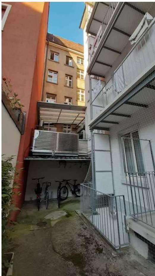
Abbildung 3: Beispiel für die gute Integration einer Wärmepumpenanlage in ein bestehendes Mehrfamilienhaus.
