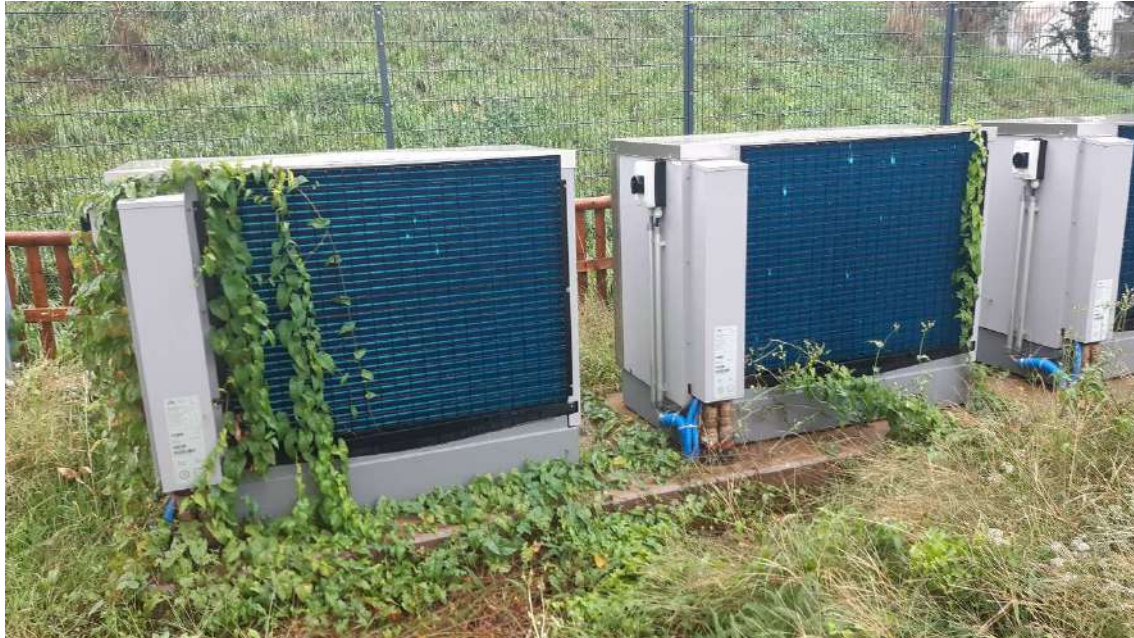
Abbildung 2: Wärmepumpe mit starkem Gartenbewuchs direkt am Luftwärmetauscher.
