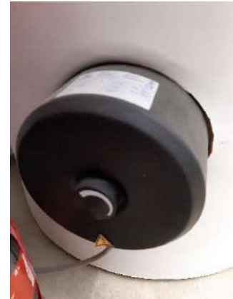
Abbildung 6: Elektroheizstab im Wassererwärmer einer Wärmepumpenanlage.
