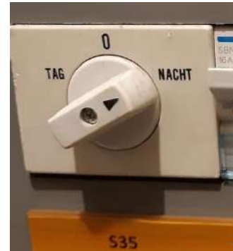
Abbildung 7: Handwahlschalter für die EVU-Steuerung des Elektroheizstabs im Wasserwärmer.
