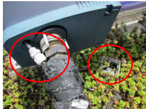
Abbildung 10: Unsauber verlegte Kollektorfühlerkabel. Nach vier Betriebsjahre war die Elektrobox offen und die Fühlerkabelbefestigung am Kollektor lose.
