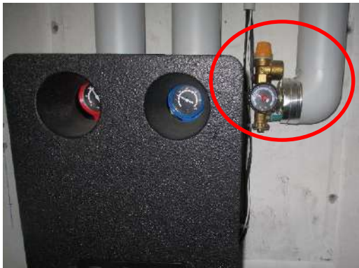
Abbildung 9: Bei fünf Anlagen fehlte das Auffanggefäss am Sicherheitsventil für das Frostschutzmittel. In diesem Fall wurde ausserdem die Auskühlstrecke zum MAG fälschlicherweise gedämmt.
