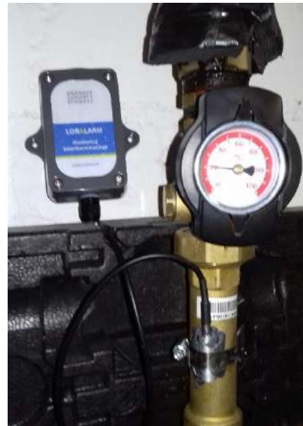
Abbildung 3: LoRaWAN-Funksensor am Solarvorlauf des Kollektorfelds einer Vakuumröhren-Kollektoranlage.
