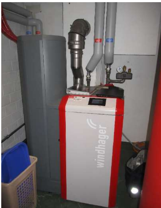
Abbildung 12: Pelletkessel für die Wärmeversorgung eines MFH.
