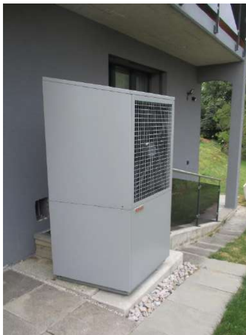
Abbildung 13: Kantonal geförderte Wärmepumpe aus der Qualitätsprüfung 2020.
